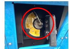
Erdungsschalter (Hauptstromrichter rechts, Stellung geerdet)
