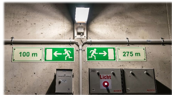
Abbildung 50: Fluchtwegkennzeichnung unter Notbeleuchtung
